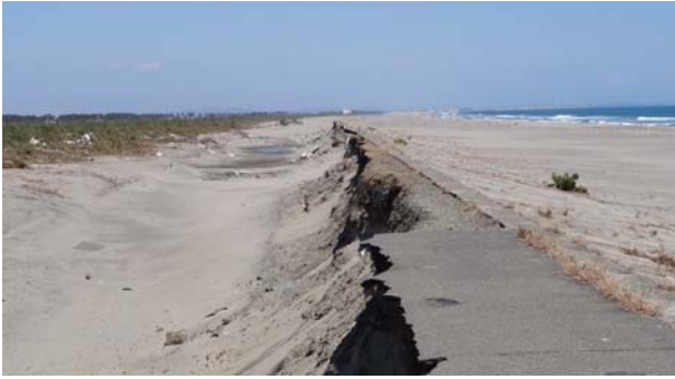
図4 仙台空港東側の海岸堤防の被害.
