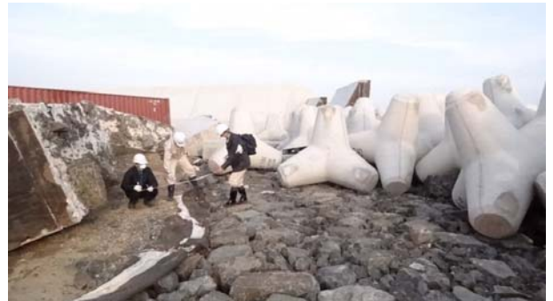
図7 高砂埠頭コンテナターミナル南東側の護岸の被害.
